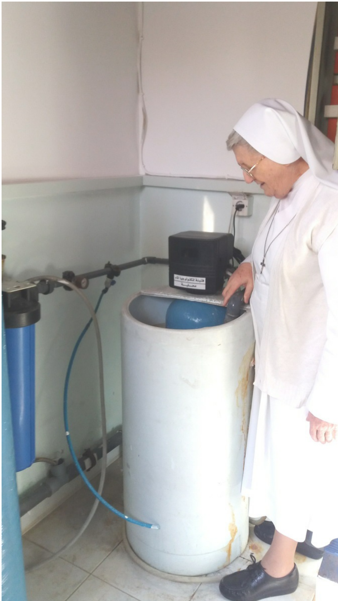
Schwester Scarzello mit Wasseraufbereitungsanlage.
