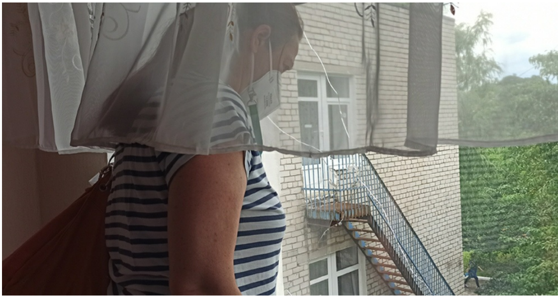
Kindergarten Rosinka, Einschussloch im Fenster; Foto: Iwana Steinigk
